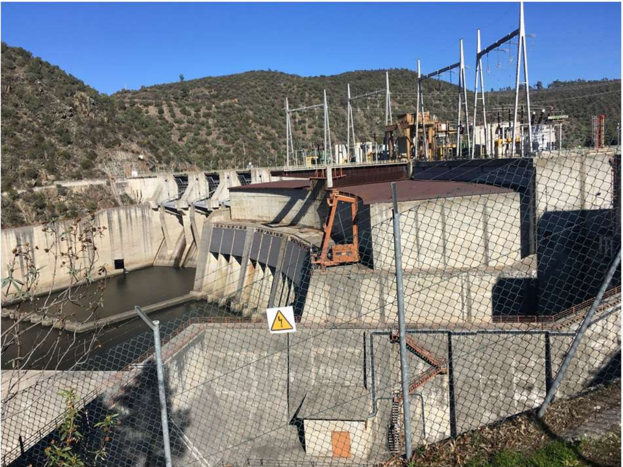
Figura 3 – Pormenor da barragem de Cedillo. O caudal efluente da barragem é nulo, como ilustrado na fotografia. Esta situação ocorre durante a maior parte do tempo, exceto nos períodos em que os caudais afluentes à albufeira, gerados na parte da bacia hidrográfica do Tejo em território de Espanha são elevados. Fotografia gentilmente cedida por Maria Manuela Portela.
